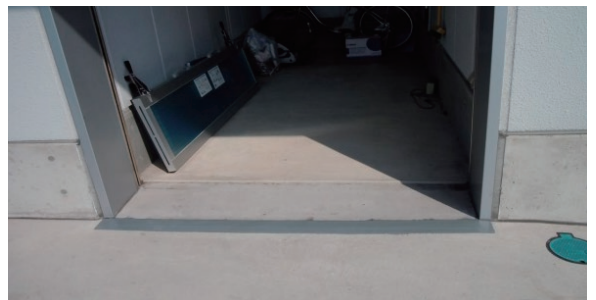
モルタル下地の不陸調整 (塗床と珪砂を混合。セルフレベルング材でも可。)
